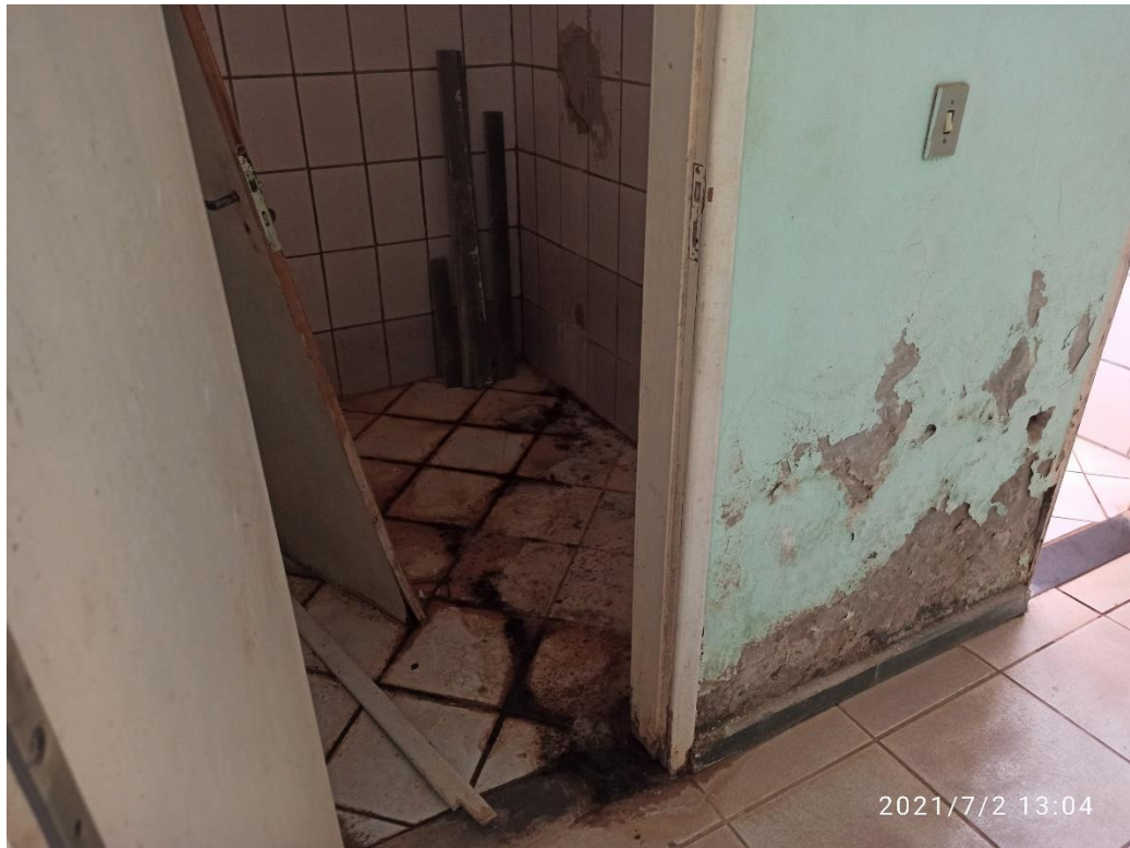
Imagem 04: Entrada de um dos banheiros utilizados pelos pacientes. Observar a ausência de porta e o estado lastimável do piso.
